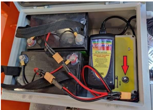
Figure 17. Système électrique de descente
