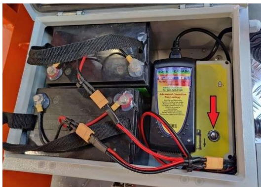
Foto 17. Sistema de descenso eléctrico
