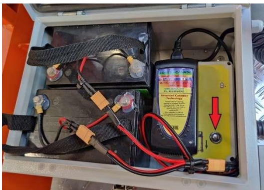
Foto 17. Sistema elettrico di discesa
