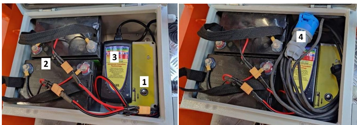
Zdj. 3 Skrzynka elektryczna
