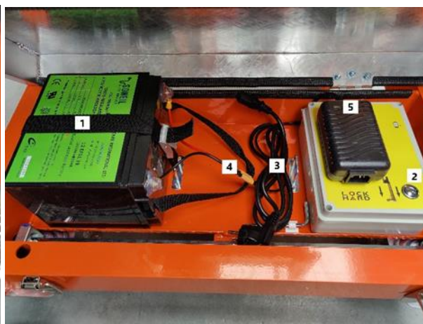
Zdjęcie 2. Skrzynka elektryczna
