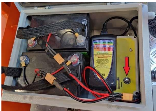
Zdjęcie 17. Elektryczny system opuszczania
